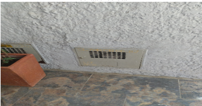
Contador de Gas
