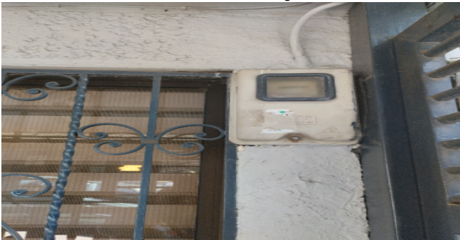
Contador de Energia
