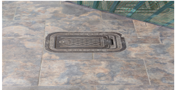
Contador de Agua
