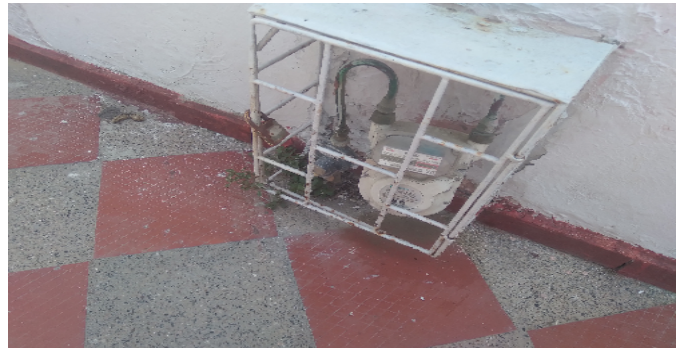
Contador de Gas
