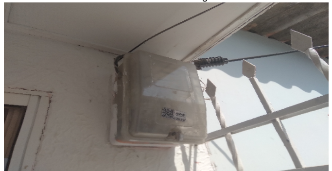
Contador de Energia
