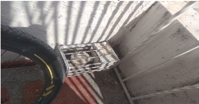
Contador de Agua
