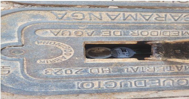
Contador de Agua
