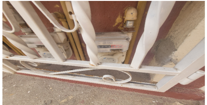
Contador de Gas
