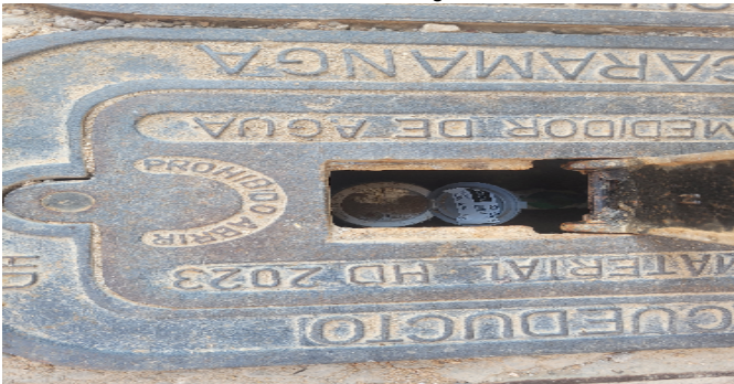
Contador de Agua
