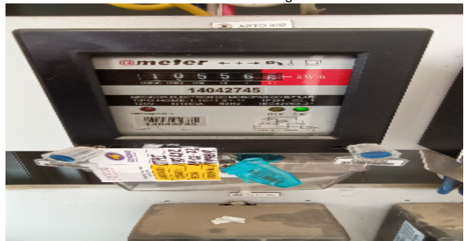
Contador de Energia
