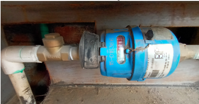
Contador de Agua
