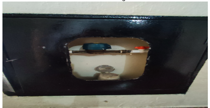
Contador de Agua
