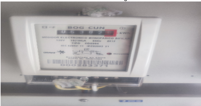
Contador de Energia
