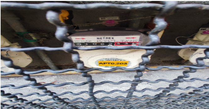
Contador de Gas
