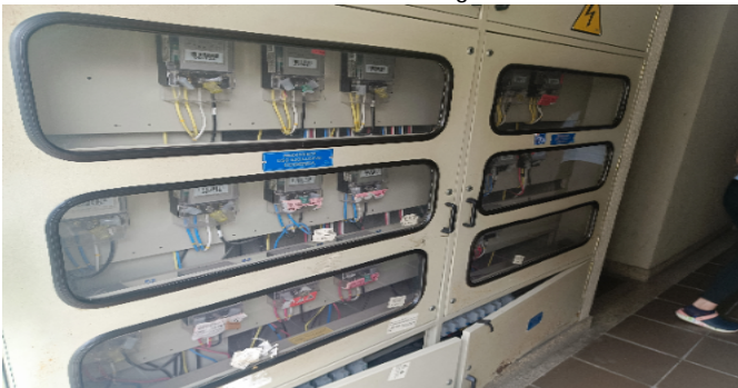
Contador de Energia
