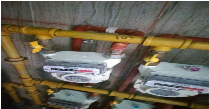
Contador de Gas
