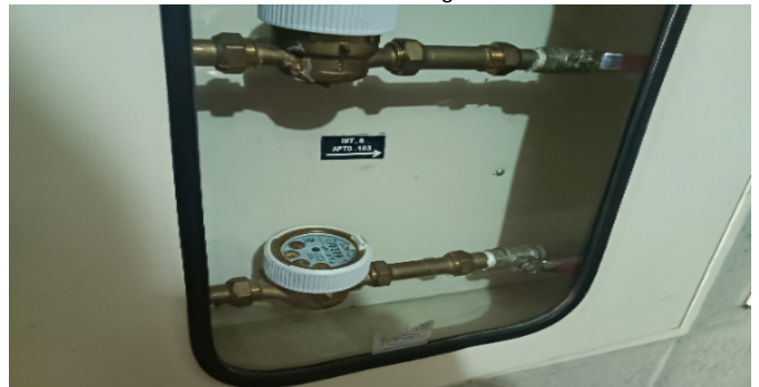
Contador de Agua
