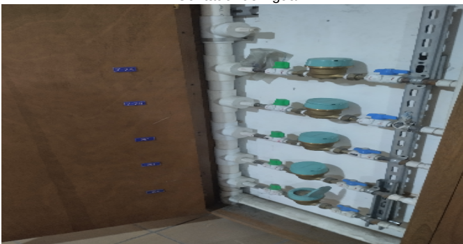
Contador de Agua
