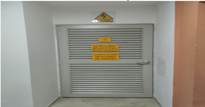
Contador de Energia
