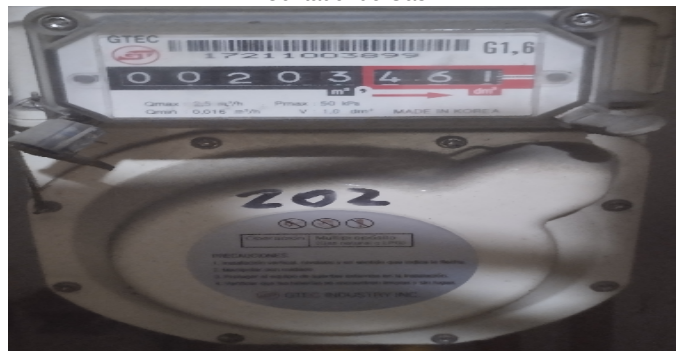
Contador de Gas
