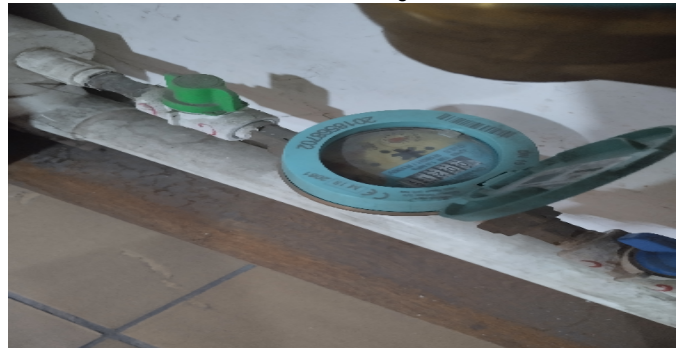
Contador de Agua
