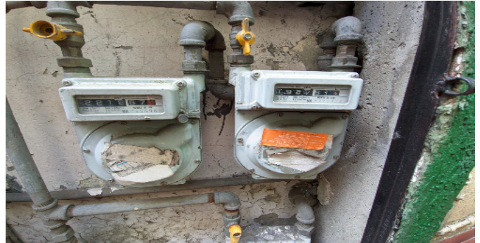
Contador de Gas
