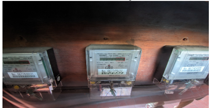
Contador de Energia
