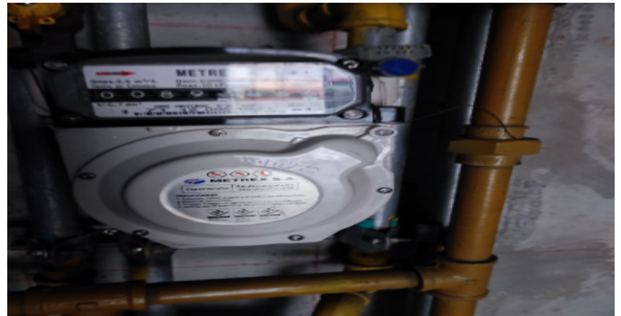
Contador de Gas
