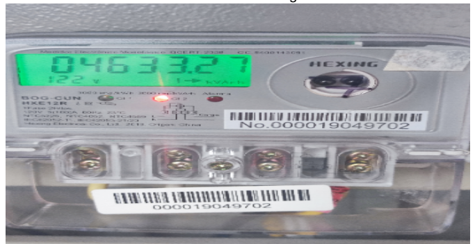
Contador de Energia
