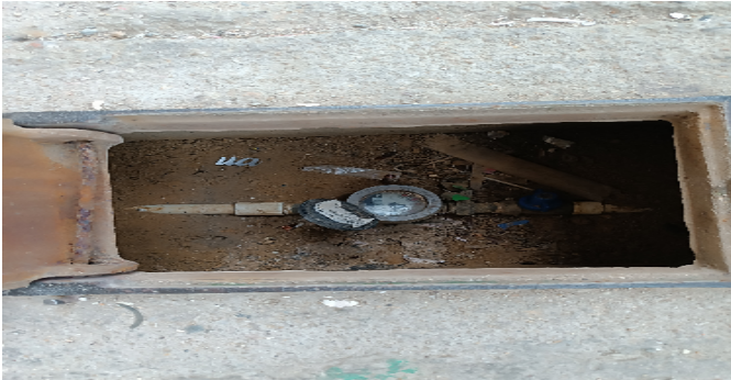
Contador de Agua
