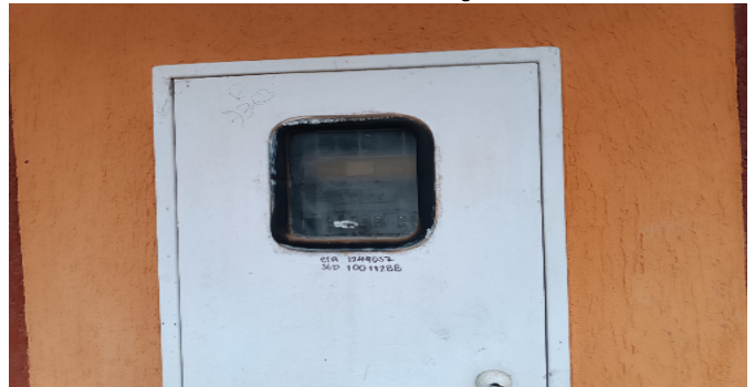
Contador de Energia
