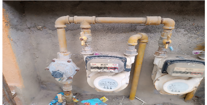
Contador de Gas
