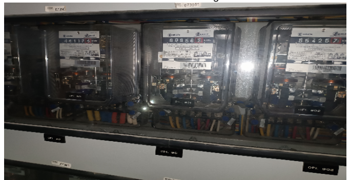
Contador de Energia
