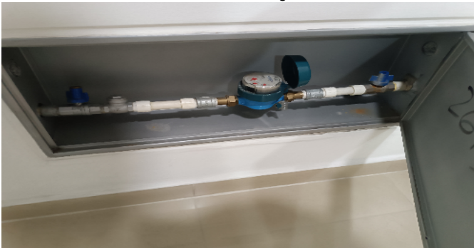
Contador de Agua
