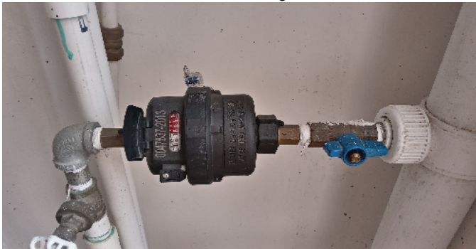
Contador de Agua
