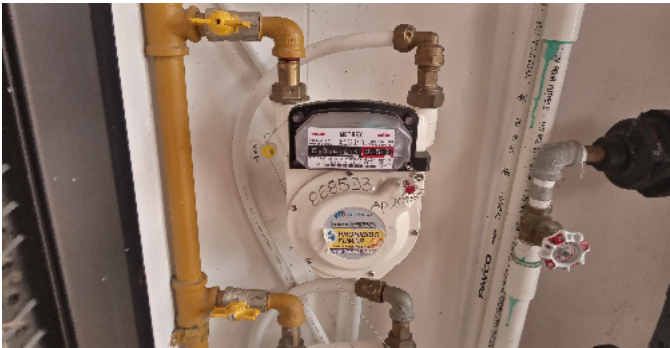
Contador de Gas
