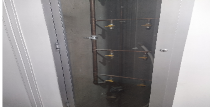
Contador de Gas
