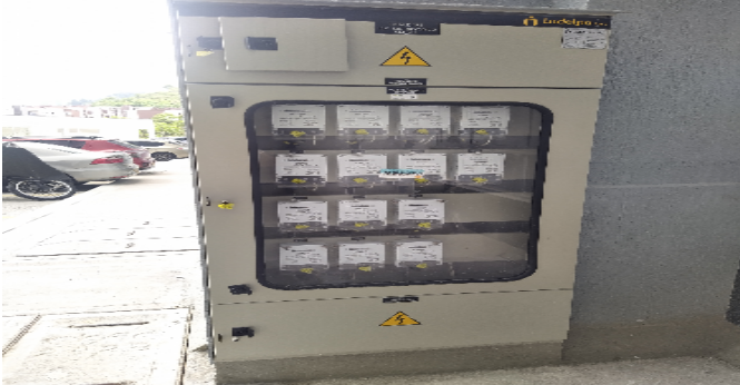
Contador de Energia
