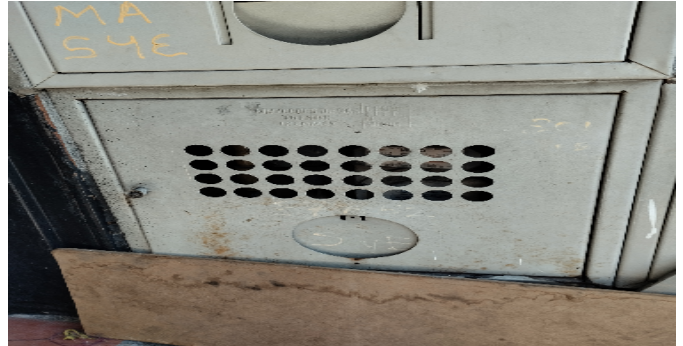
Contador de Gas
