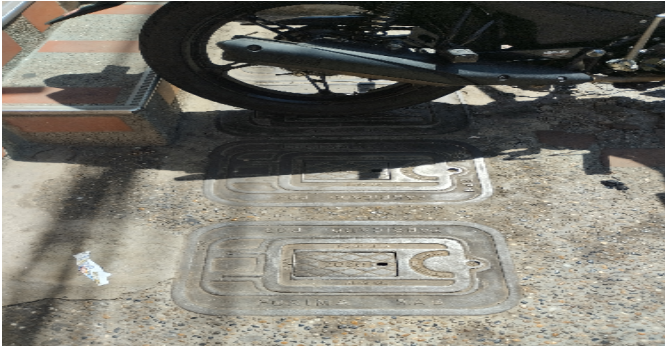
Contador de Agua
