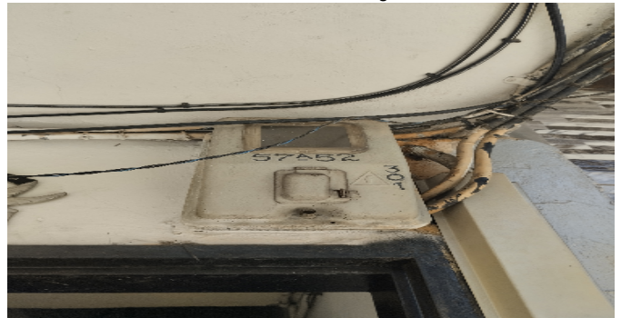
Contador de Energia
