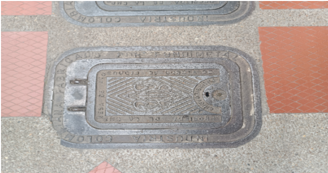
Contador de Agua
