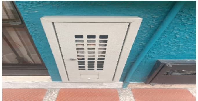
Contador de Gas
