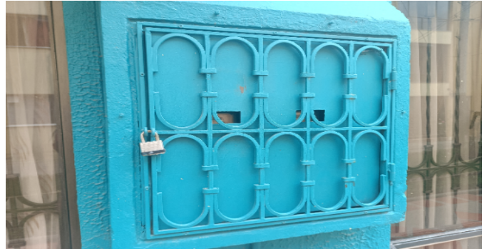
Contador de Energia
