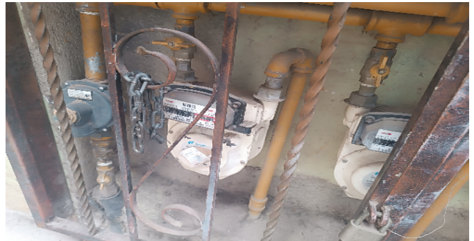
Contador de Gas
