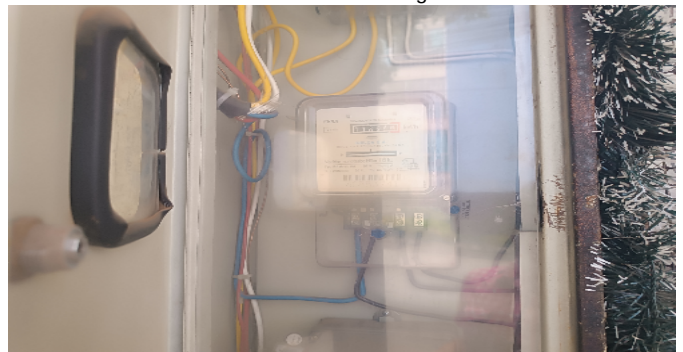
Contador de Energia
