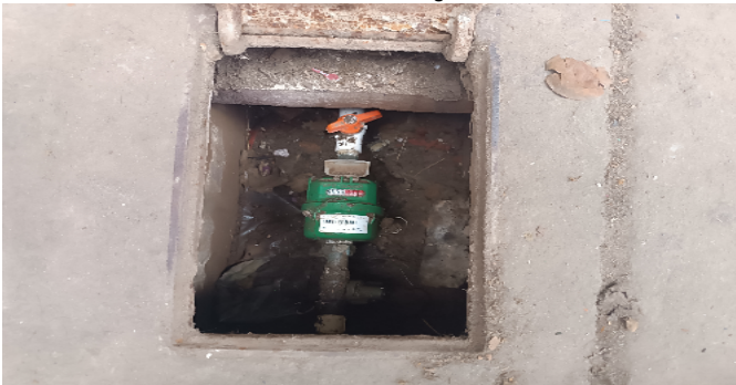
Contador de Agua
