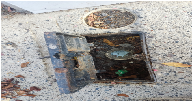
Contador de Agua
