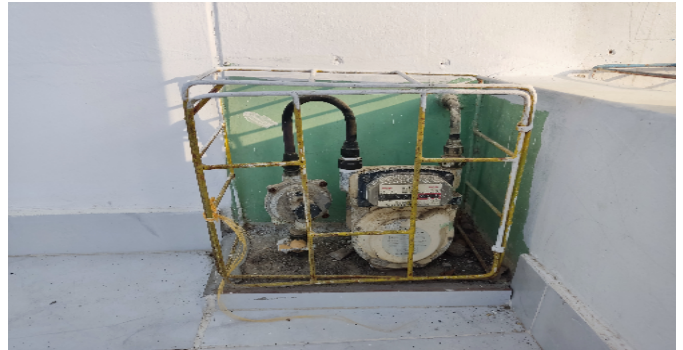
Contador de Gas
