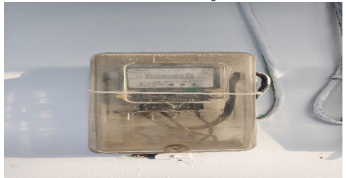
Contador de Energia
