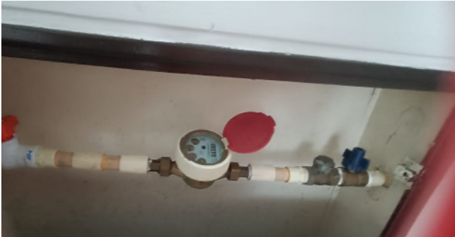
Contador de Agua
