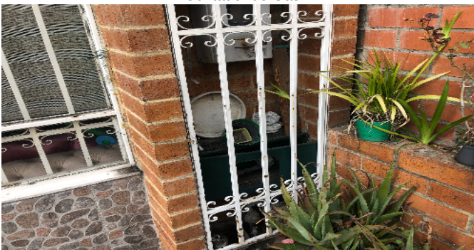
Contador de Gas
