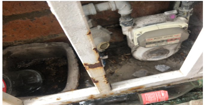
Contador de Gas
