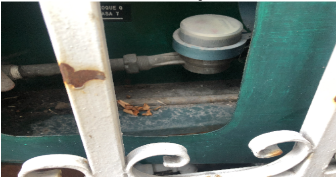
Contador de Agua
