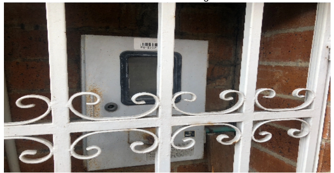
Contador de Energia
