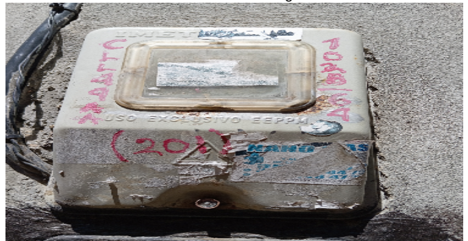
Contador de Energia
