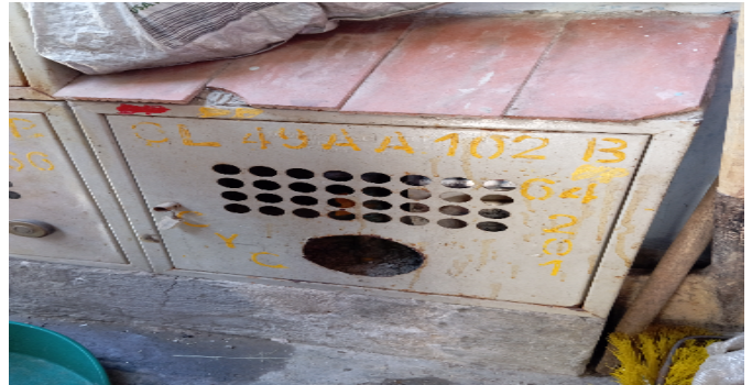
Contador de Gas
