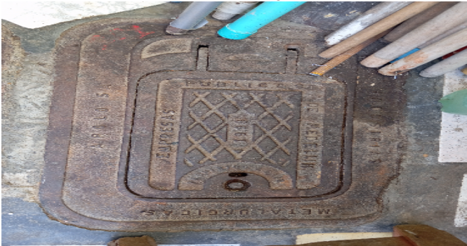
Contador de Agua
