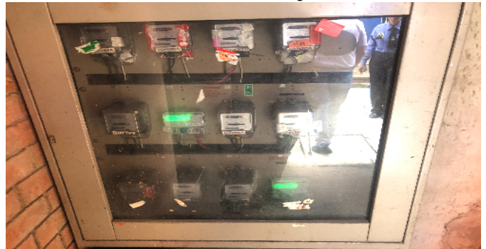
Contador de Energia
