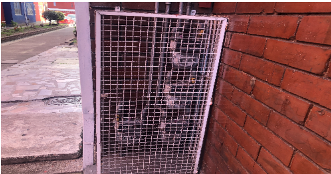
Contador de Gas
