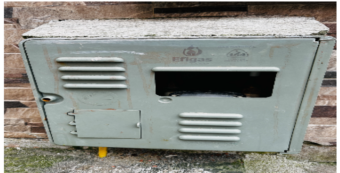
Contador de Gas
