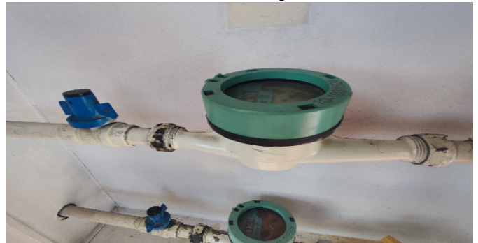
Contador de Agua
