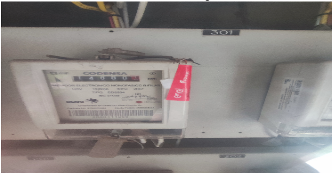
Contador de Energia
