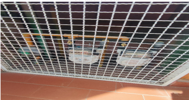
Contador de Gas
