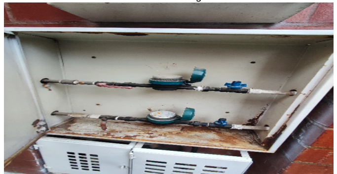
Contador de Agua
