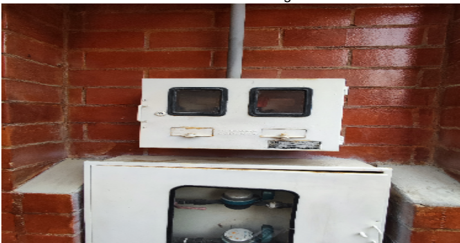
Contador de Energia
