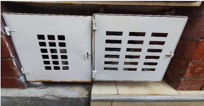
Contador de Gas
