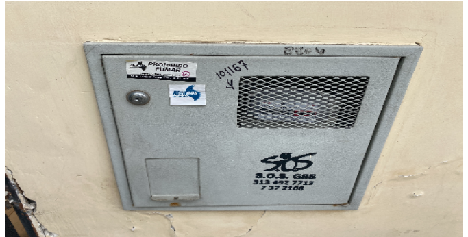
Contador de Gas
