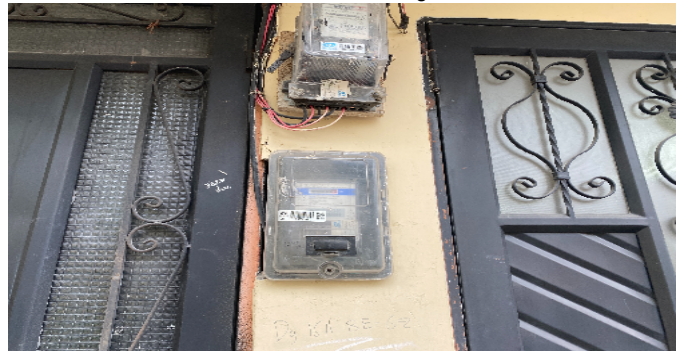
Contador de Energia
