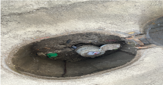
Contador de Agua
