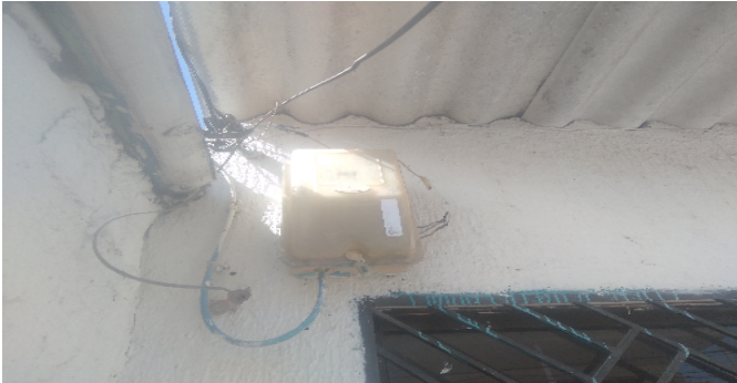
Contador de Energia
