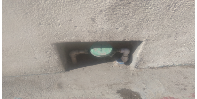
Contador de Agua
