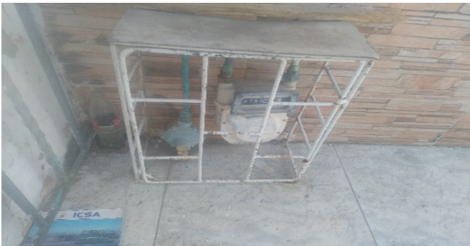
Contador de Gas
