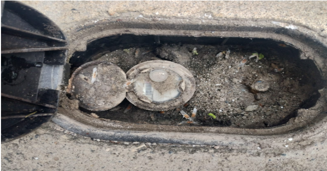
Contador de Agua
