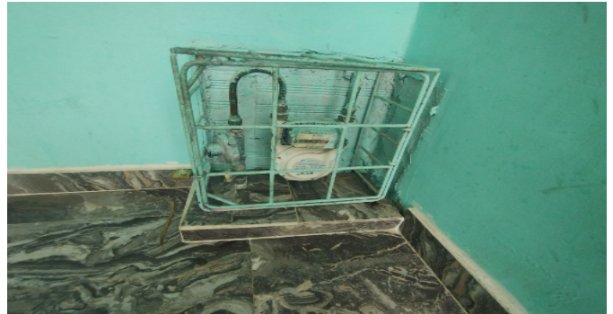
Contador de Gas
