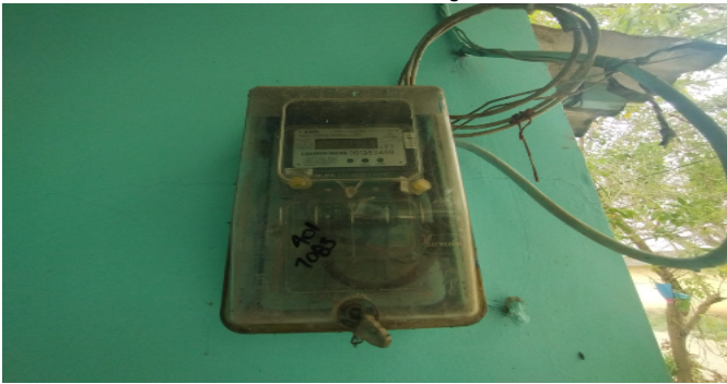
Contador de Energia
