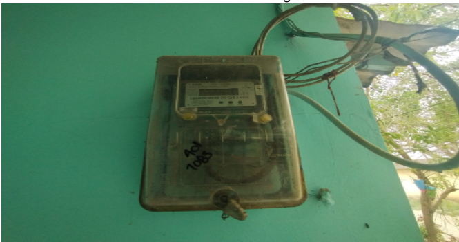
Contador de Energia
