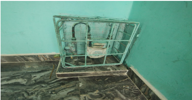
Contador de Gas
