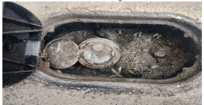
Contador de Agua
