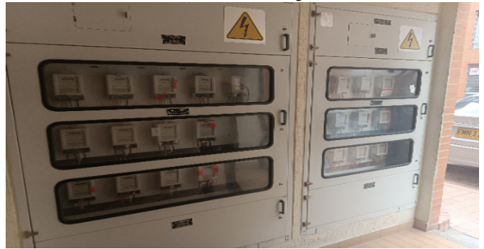
Contador de Energia
