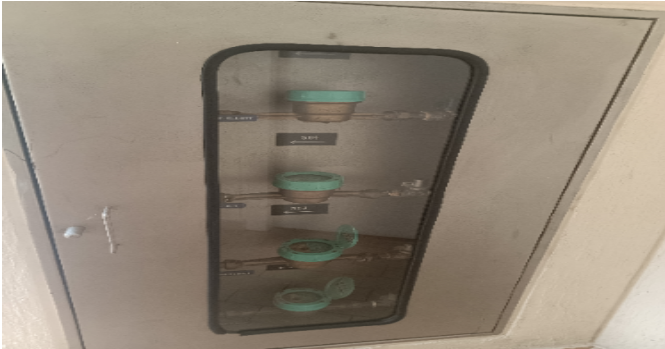
Contador de Agua
