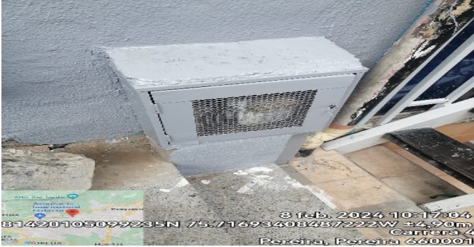
Contador de Gas
