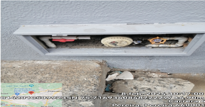
Contador de Agua
