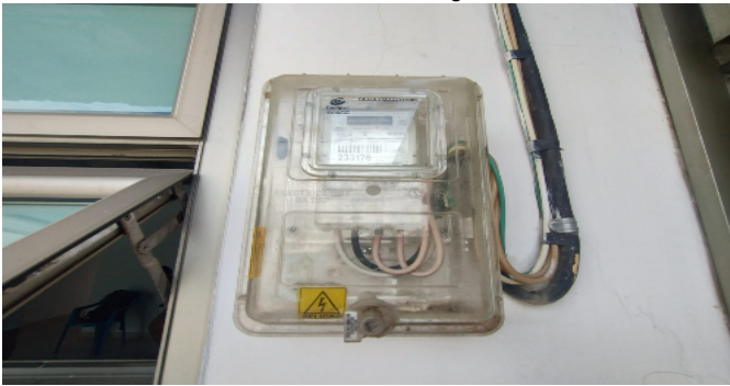
Contador de Energia
