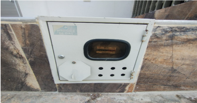
Contador de Gas
