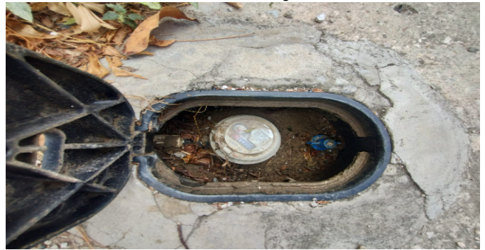
Contador de Agua
