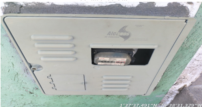
Contador de Gas
