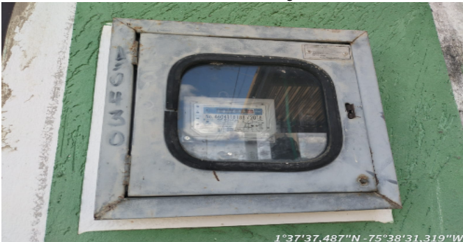
Contador de Energia
