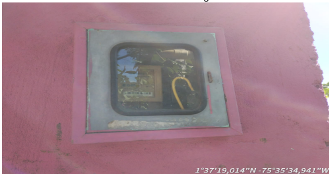
Contador de Energia
