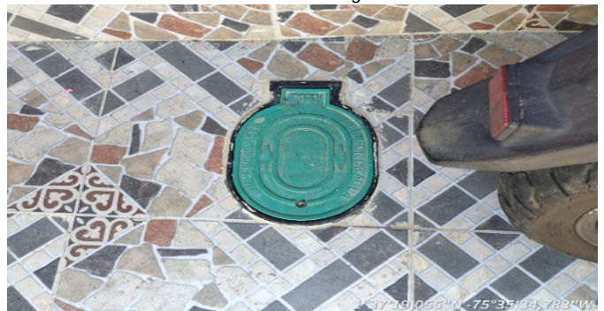
Contador de Agua
