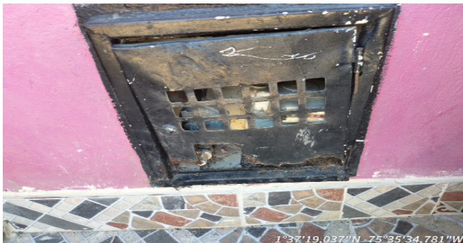
Contador de Gas
