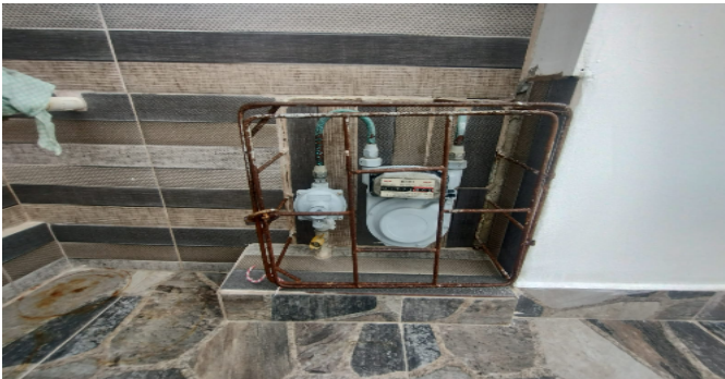
Contador de Gas
