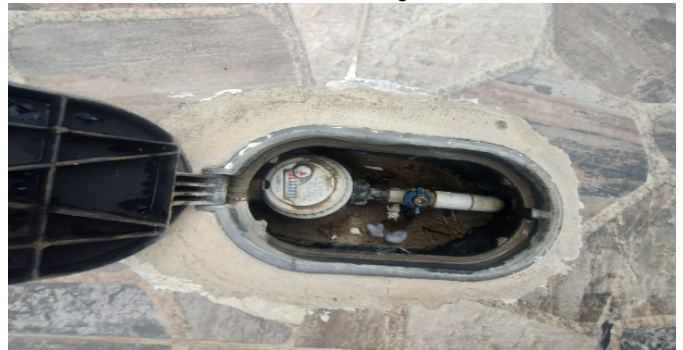
Contador de Agua
