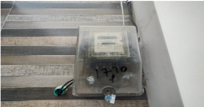
Contador de Energia
