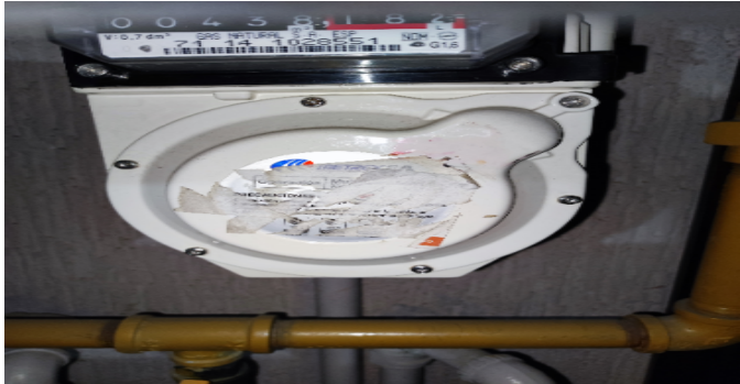
Contador de Gas
