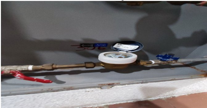
Contador de Agua
