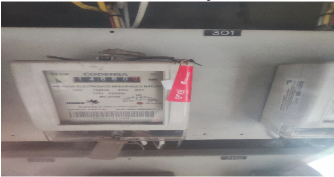
Contador de Energia
