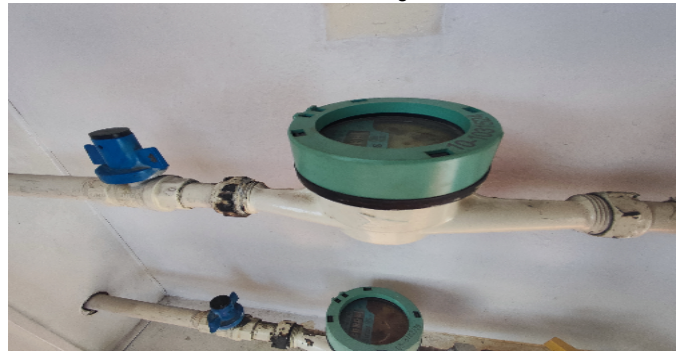
Contador de Agua
