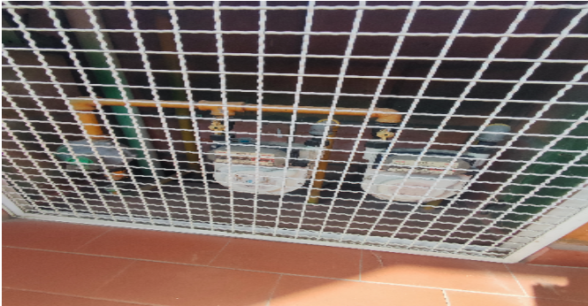
Contador de Gas
