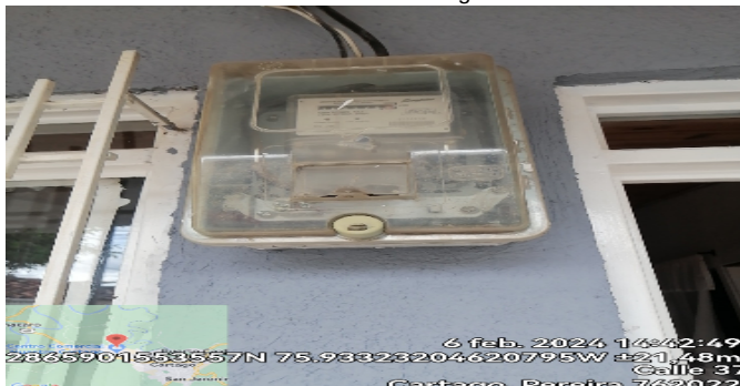
Contador de Energia
