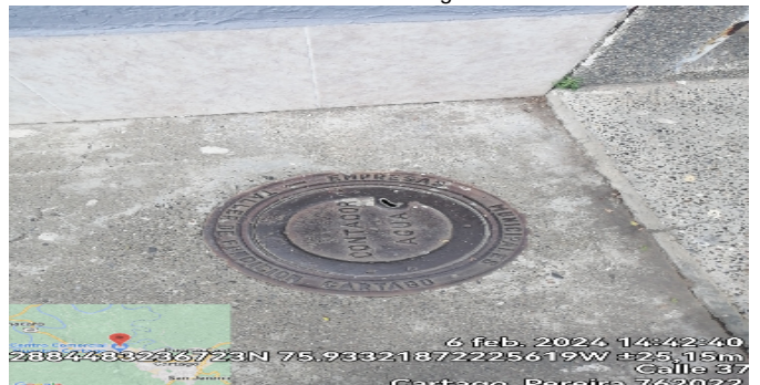
Contador de Agua
