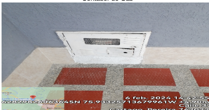
Contador de Gas
