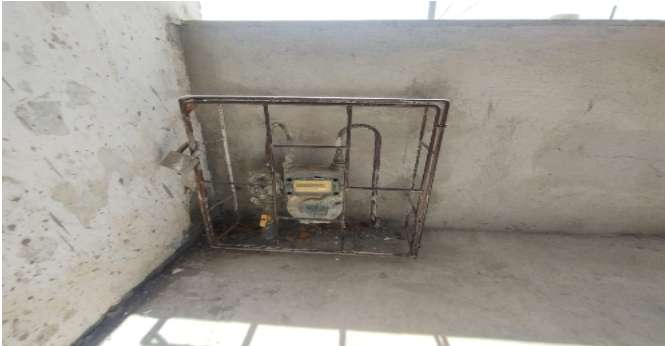
Contador de Gas
