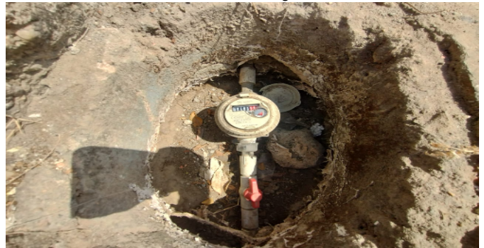
Contador de Agua
