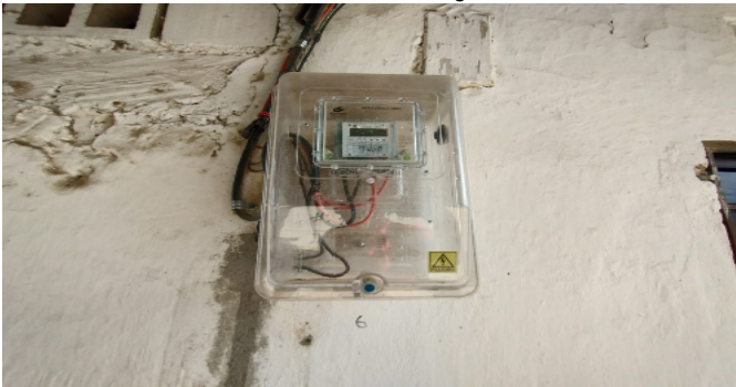
Contador de Energia
