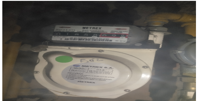
Contador de Gas
