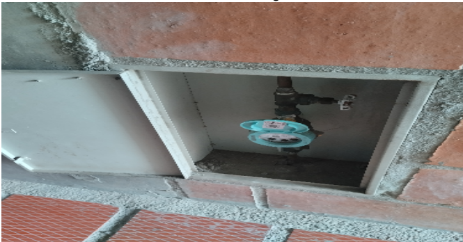
Contador de Agua
