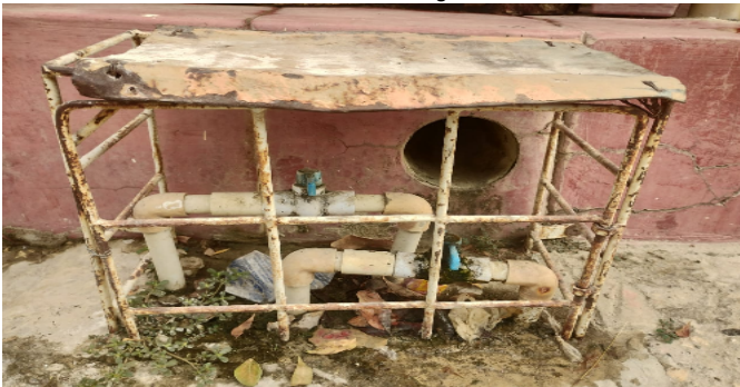
Contador de Agua
