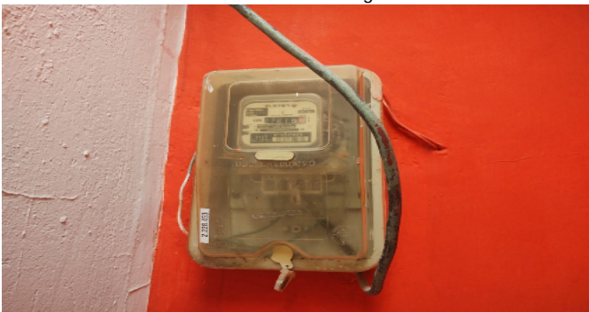
Contador de Energia
