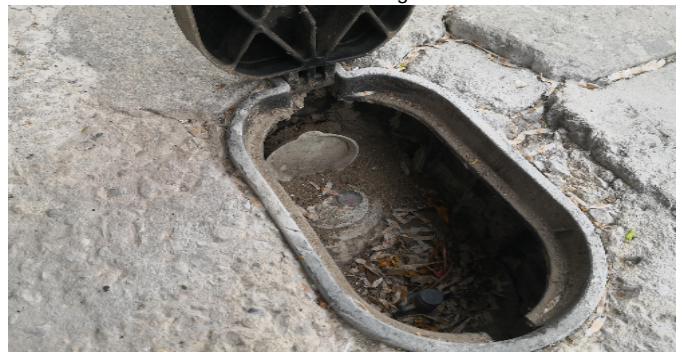
Contador de Agua
