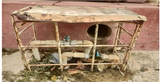
Contador de Gas
