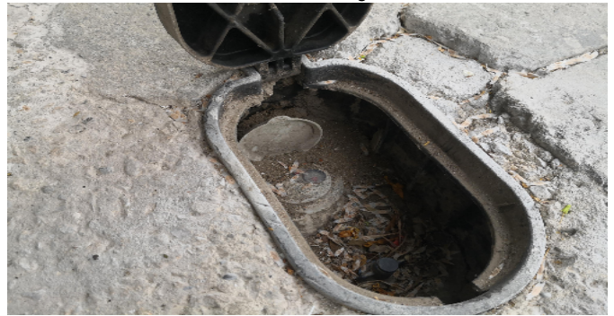
Contador de Agua
