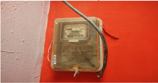
Contador de Energia
