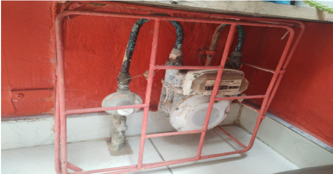
Contador de Gas
