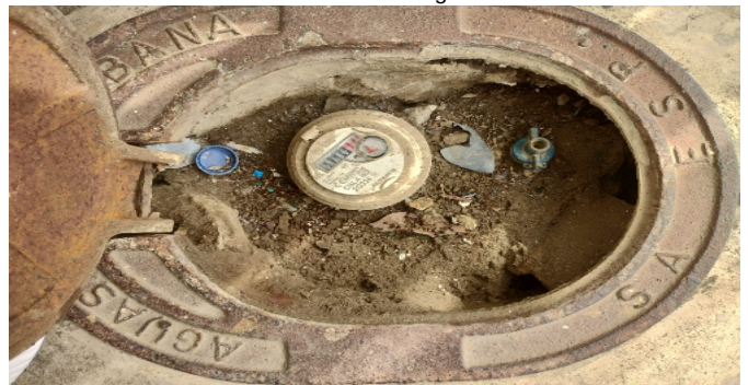
Contador de Agua
