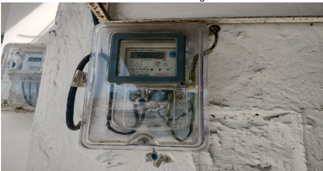
Contador de Energia
