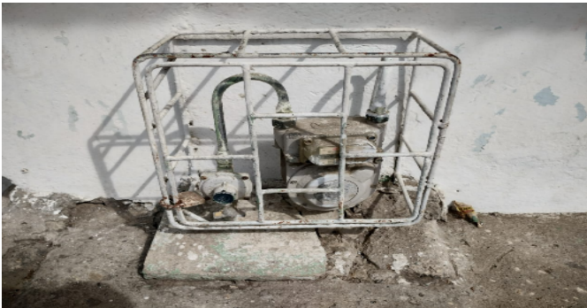
Contador de Gas
