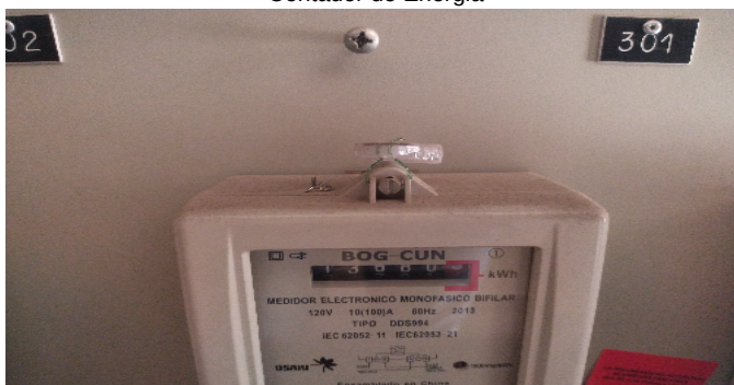
Contador de Energia
