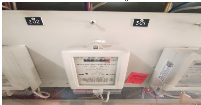
Contador de Energia
