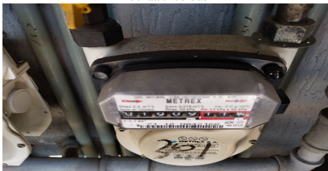
Contador de Gas
