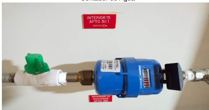
Contador de Agua
