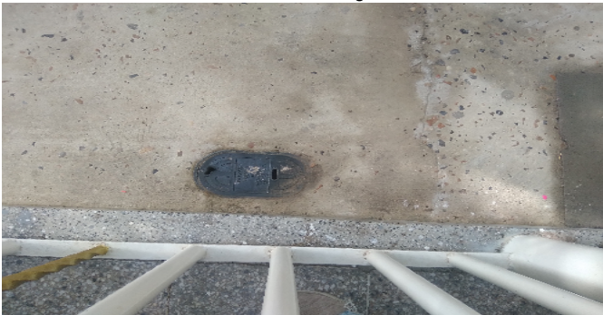
Contador de Agua
