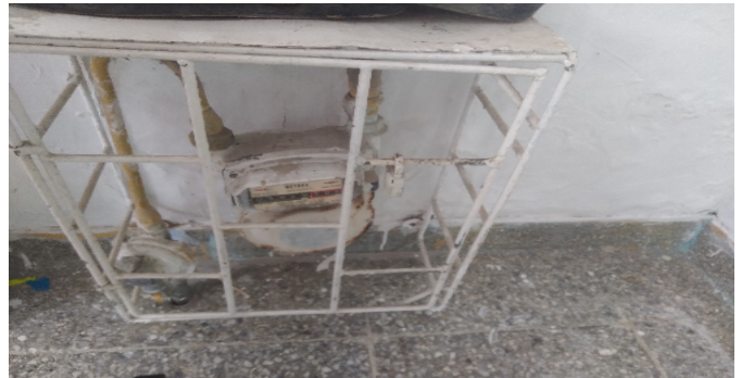
Contador de Gas
