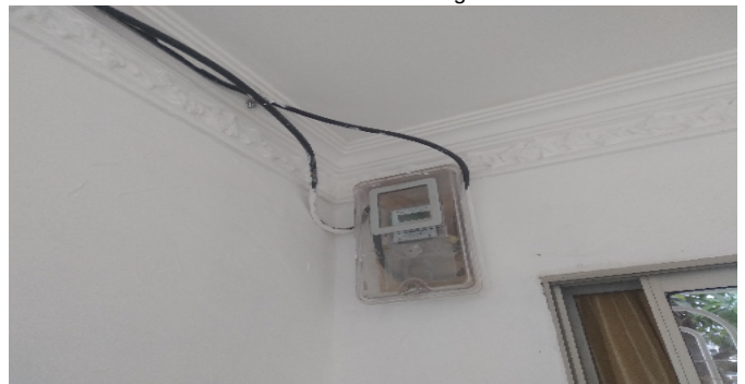
Contador de Energia
