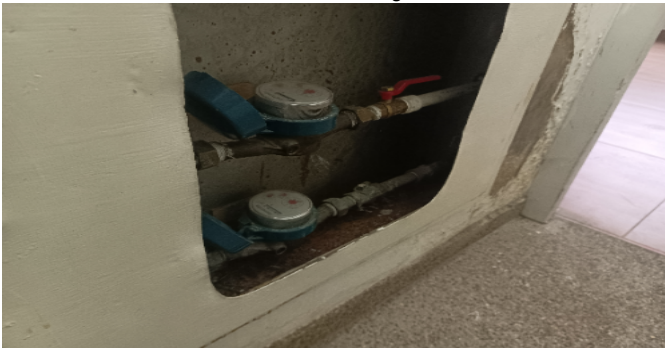
Contador de Agua
