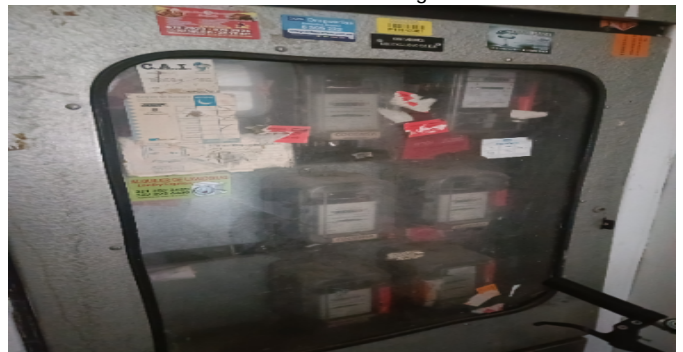
Contador de Energia
