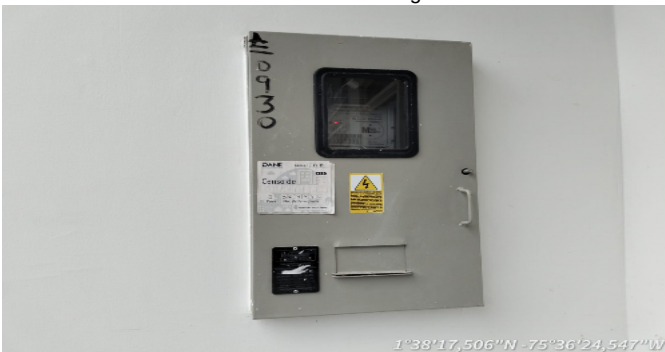
Contador de Energia
