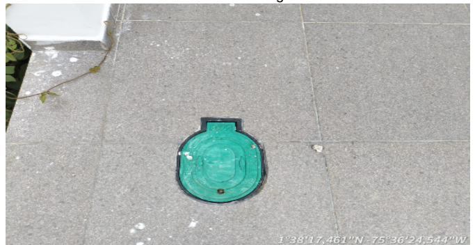
Contador de Agua
