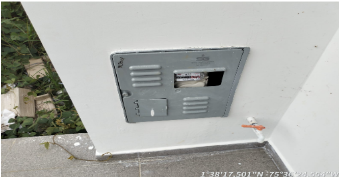
Contador de Gas
