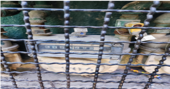
Contador de Gas
