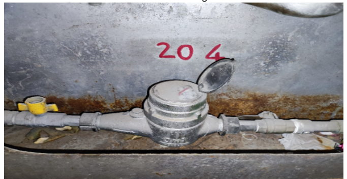
Contador de Agua
