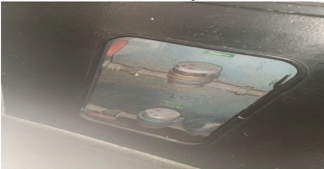
Contador de Agua
