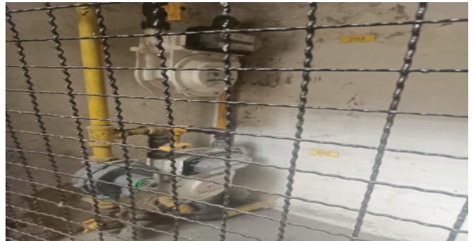
Contador de Gas
