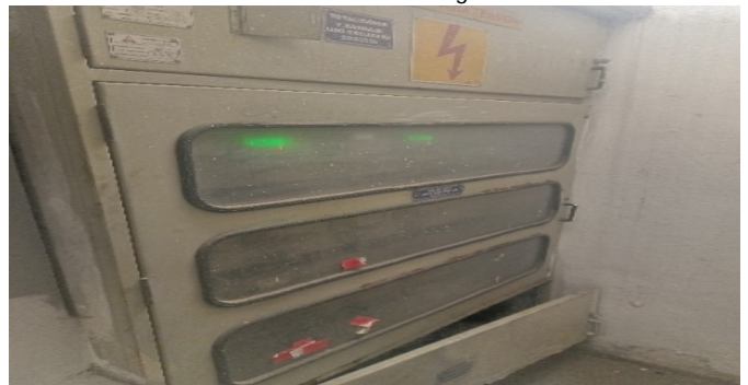
Contador de Energia
